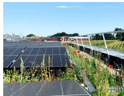
Eine PV-Anlage auf dem Betriebsgebäude einer Umspannanlage lässt sich leicht installieren und kann den Eigenbedarf an Strom decken.
