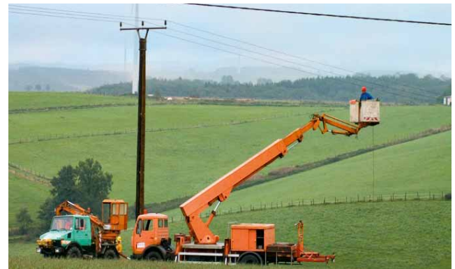
Beispiel: Anwendungsbereich Stromversorgung
