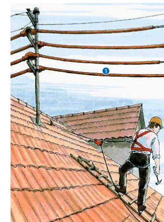
Abb. 4 Dacharbeiten in der Nähe von Niederspannungsfreileitungen
